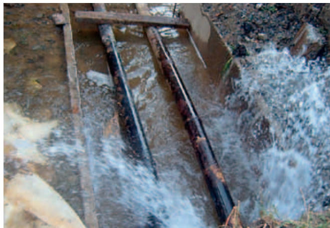
С 2013 по 2017 гг. ФРТП зафиксировал, по данным СМИ, 2800 фактов, связанных с авариями изношенных трубопроводов в системах тепло- и водоснабжения.
