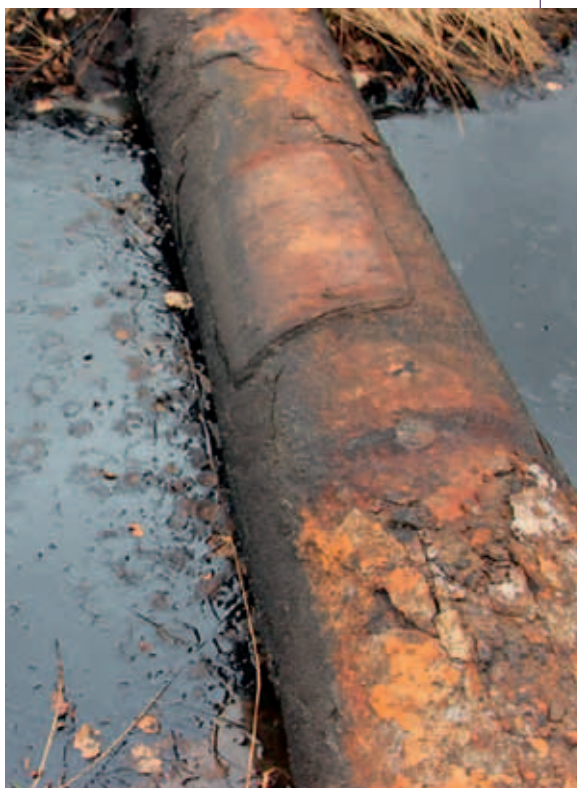
В ходе демонтажа отработавшей трубы происходят массовые разливы углеводородов.
